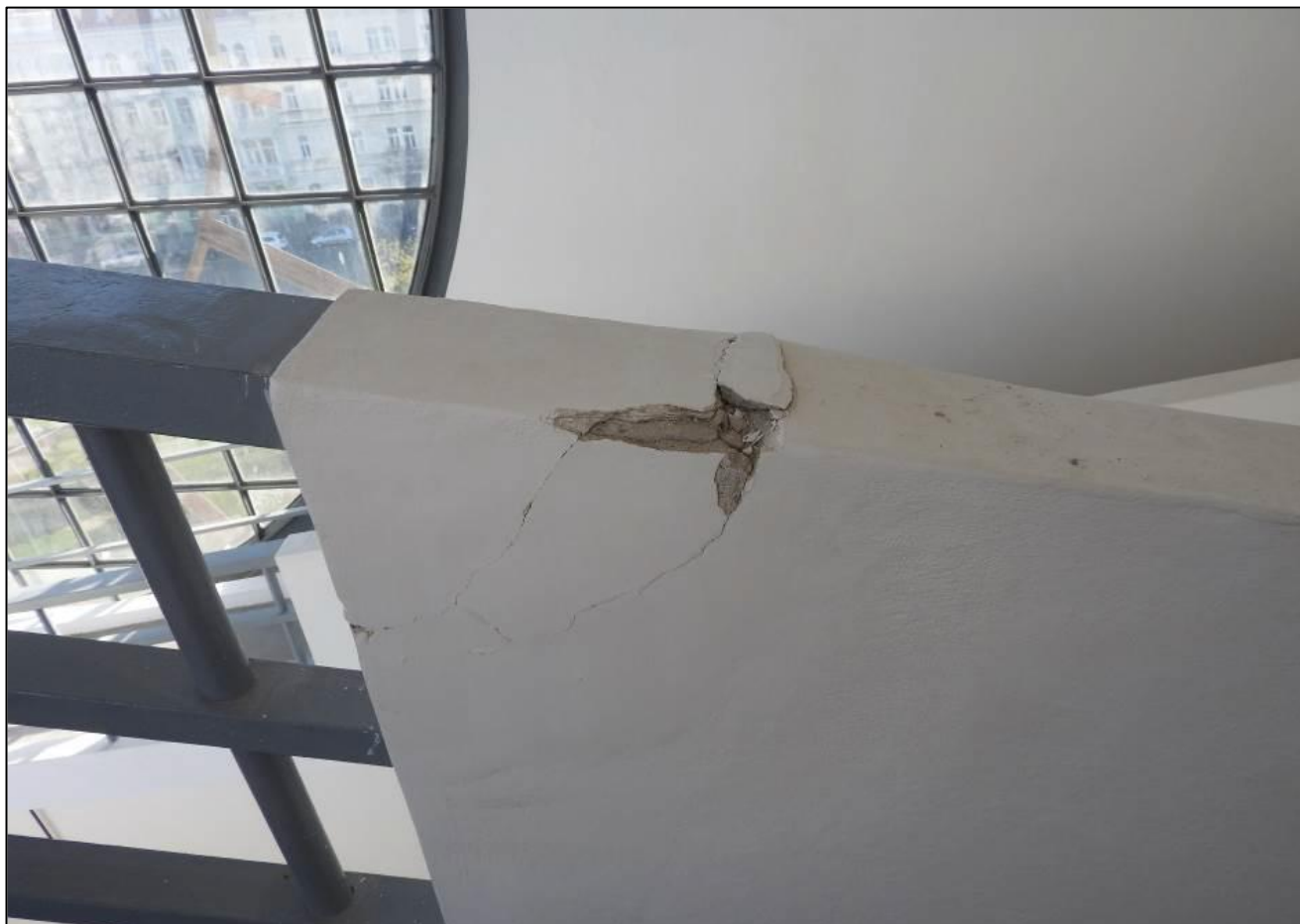
Obrázek 8: Porušení v místě ukotvení zábradlí rampy vlivem teploty
