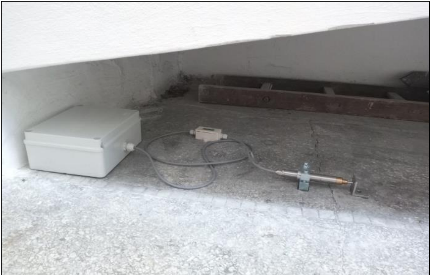
Obrázek 5: Snímač automatického měření změny šířky trhliny s elektronikou na odeslání naměřených dat do kanceláře geotechnického monitoringu (ke konstrukci přilepeno)
