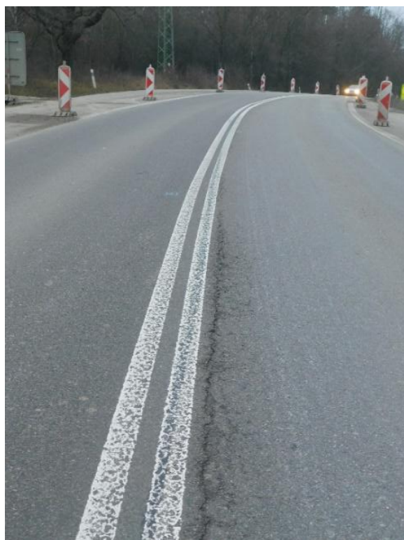
Obrázek 5: Pozice trhliny povrchu silnice I/17.
