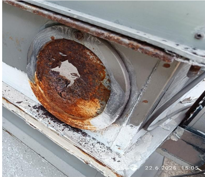
Obrázek 12: Stav zařízení pro větrání tunelových propojek po téměř 19 letech provozu
