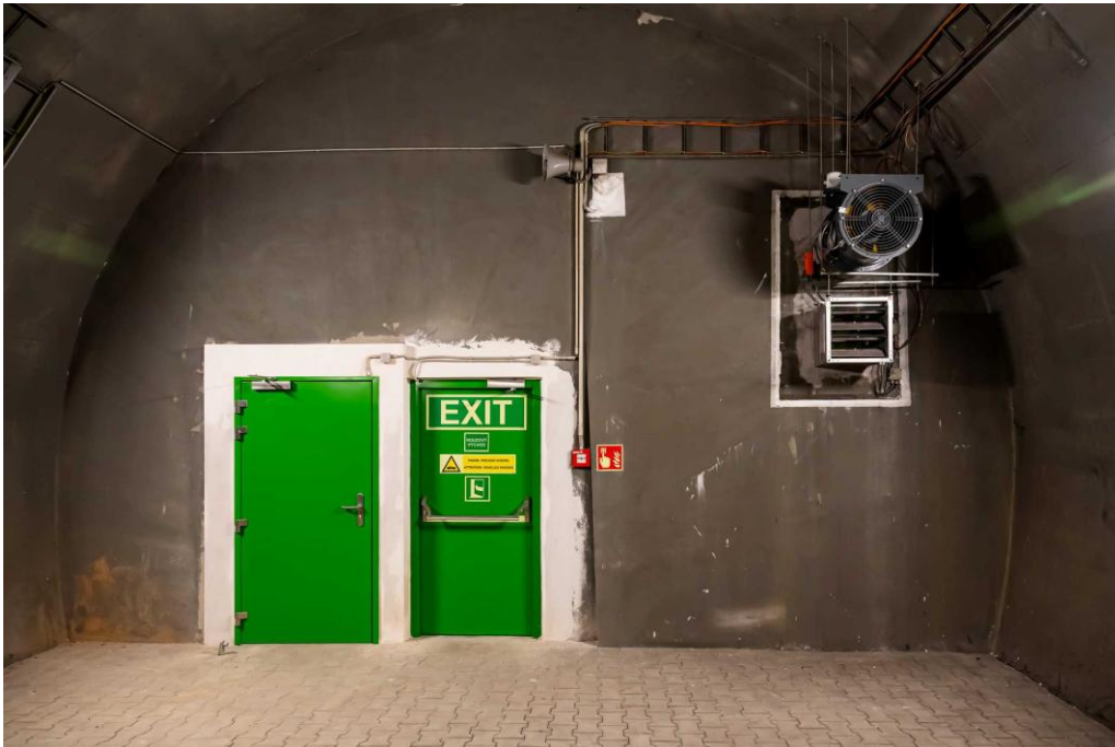
Obrázek 13: Nově osazené zařízení pro větrání tunelových propojek
