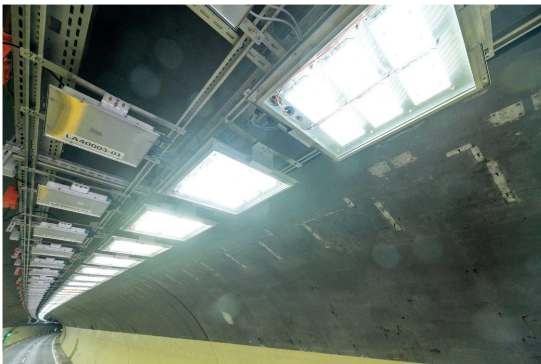
Obrázek 3: Dokončené nové LED osvětlení ve vjezdovém adaptačním pásmu
