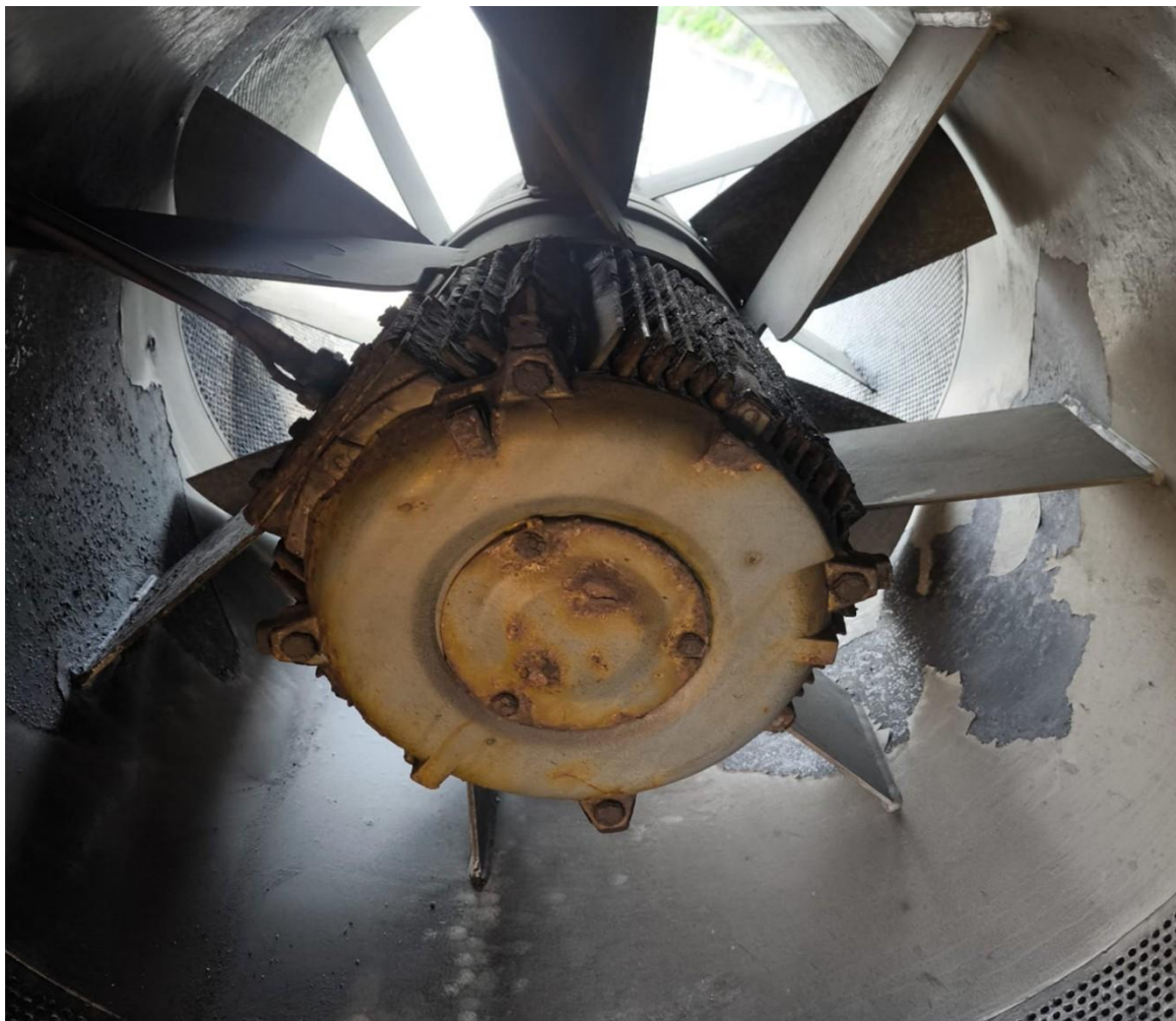
Obrázek 9: Stav původních proudových ventilátorů po téměř 19 letech provozu
