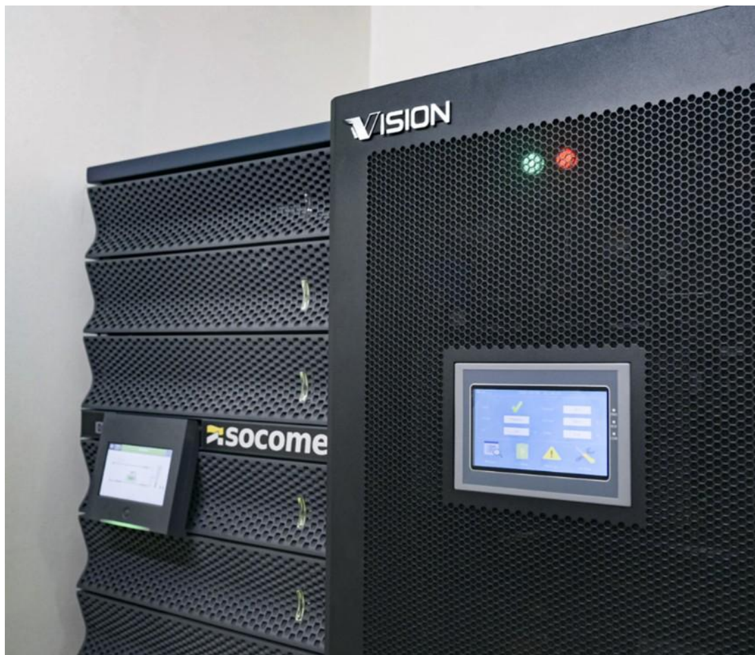
Obrázek 8: Nová UPS s Li-Ion bateriemi
