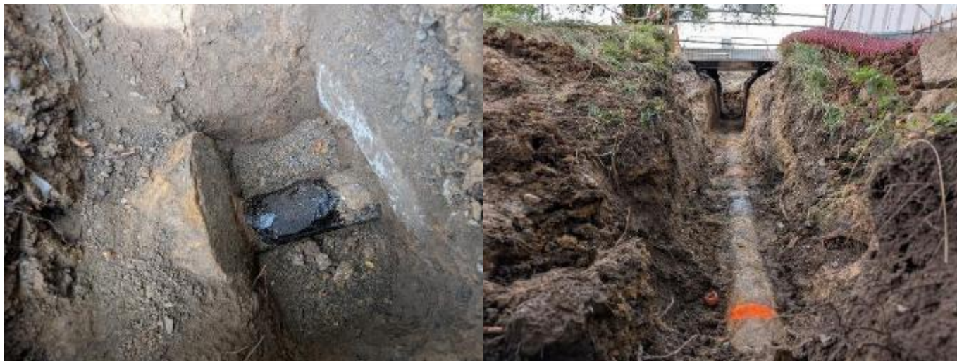
Obrázek 17 Vysokotlaký plynovod a jeho chránička (vlevo), obnažená chránička (vpravo)
