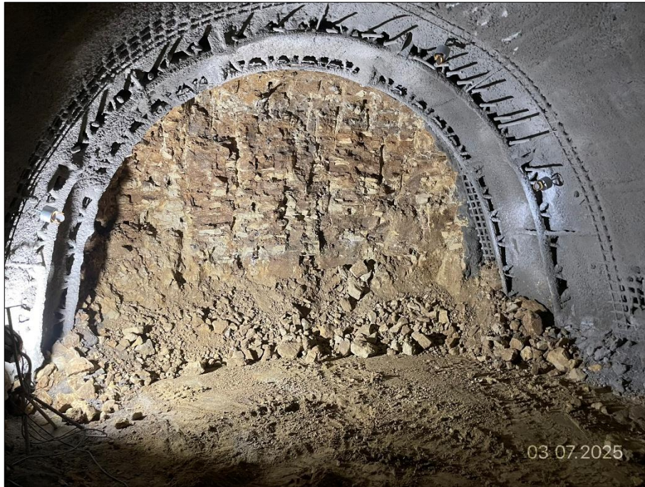
Obrázek 6: Nezajištěné čelo kaloty různě zvětralých slínovců při ražbě od šachty Š8 k TK7; (foto autora)
