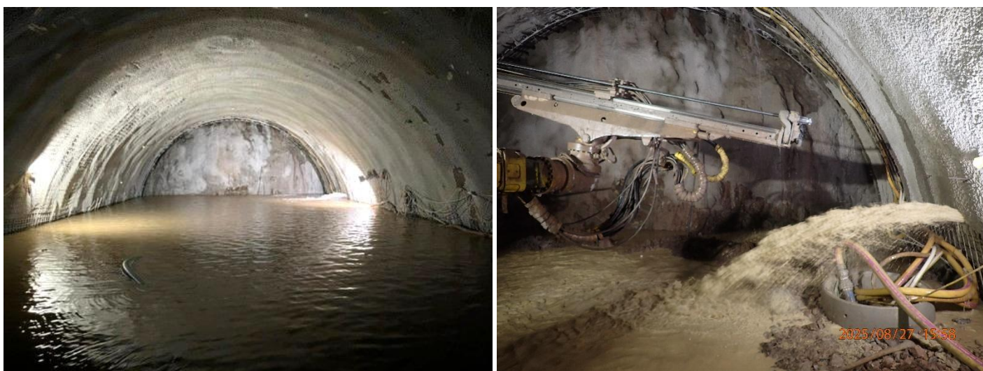
Obrázek 8 a 9: Průval vody na kalotě v oblasti Zechsteinu.
