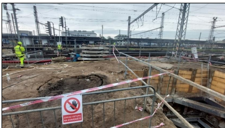
Obrázek 5: Propad povrchu u startovací šachty.
