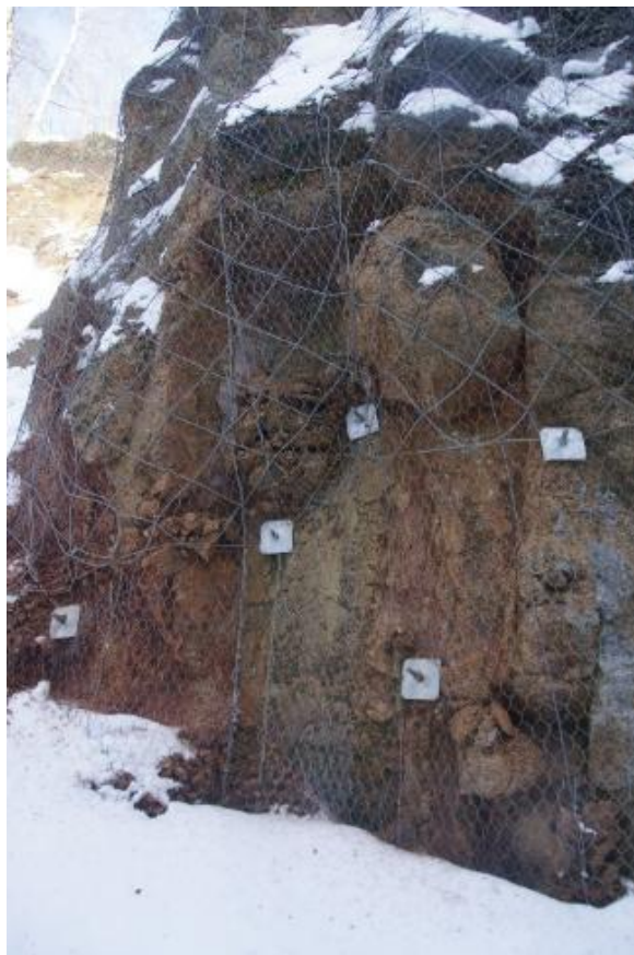
Obrázek 2 Blok horniny zachycený ve vysokopevnostní síti na boku skalního zářezu
