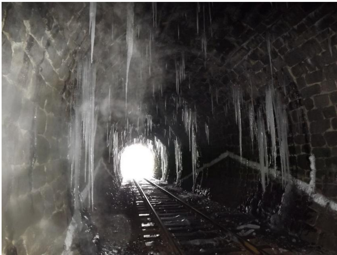
Obrázek 5 Masivní zalednění tunelu průsaky podzemní vody
