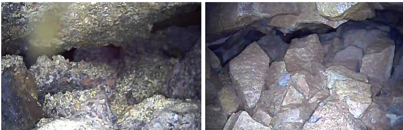
Obr. 14 Dutiny zastižené kamerou za původním ostěním tunelu
