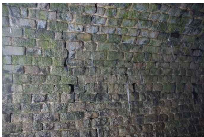
Obrázek 4 Vertikální trhliny v ostění
