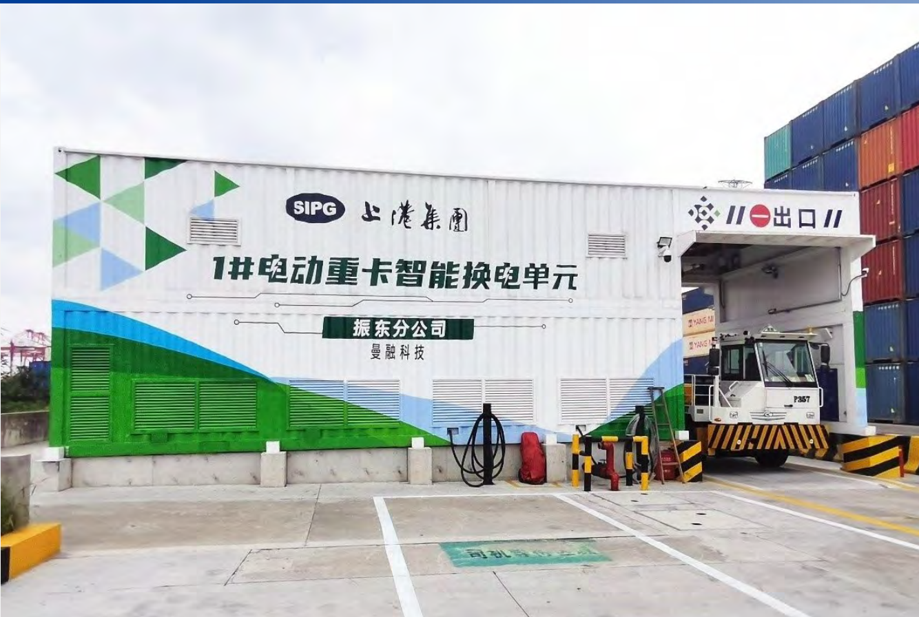
内集卡换电站
