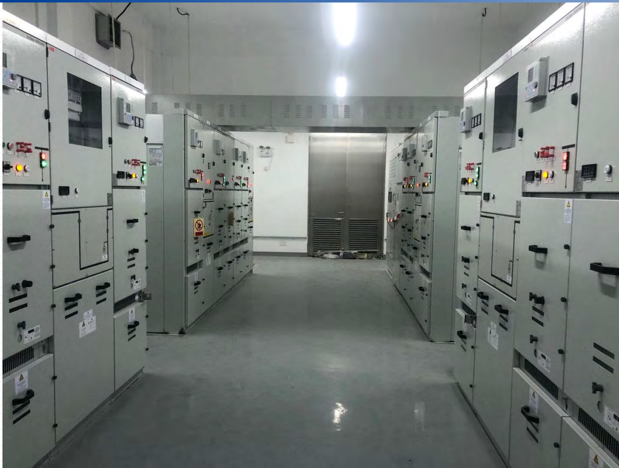
岸基供电变电设备
